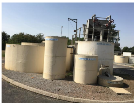
Station de traitement Vaux-Andigny 1500 EH.
